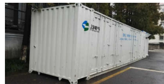
数100kW コンテナタイプ ESS
